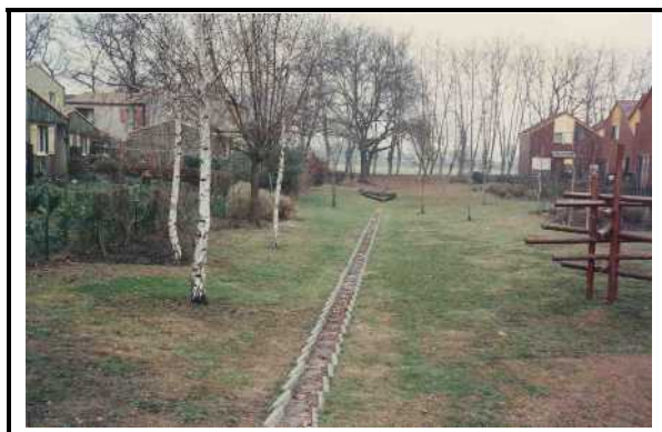
Noue et cunette en béton à Villaboiss Bruges (33) Source CETE du Sud-Ouest
