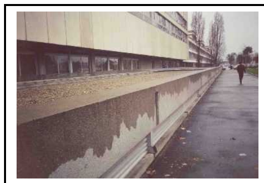
Aménagement en décroché de toiture-terrasse sur site hospitalier Source CETE du Sud-Ouest
