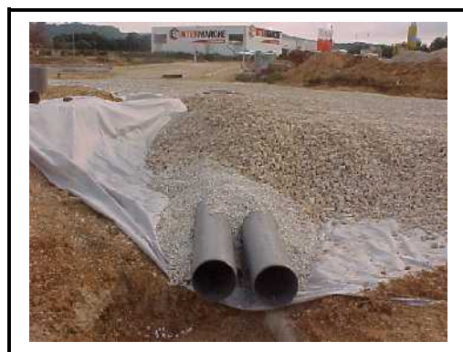
Vue de la structure de St Mathieu de Trévières (34) avec les drains Ø 300 mm Source DDE 34
